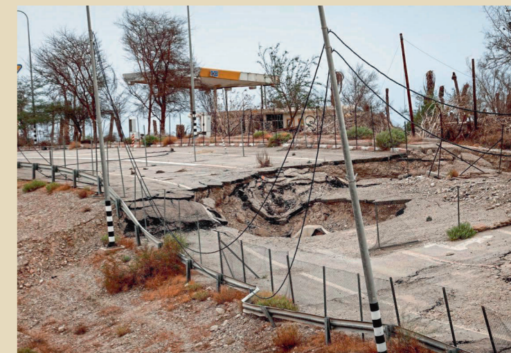
In bewohntem Gebiet sinken Straßen und Gebäude ein.
